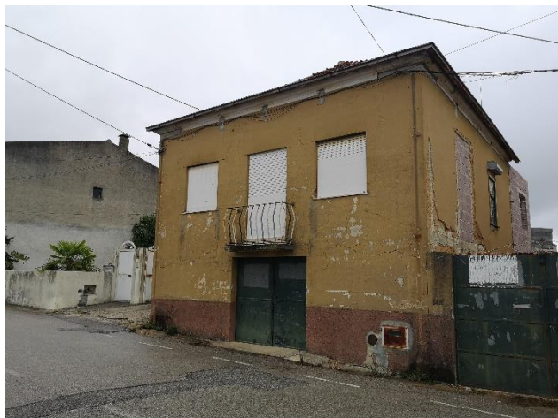
Figura 37. Fachada com fissuras
