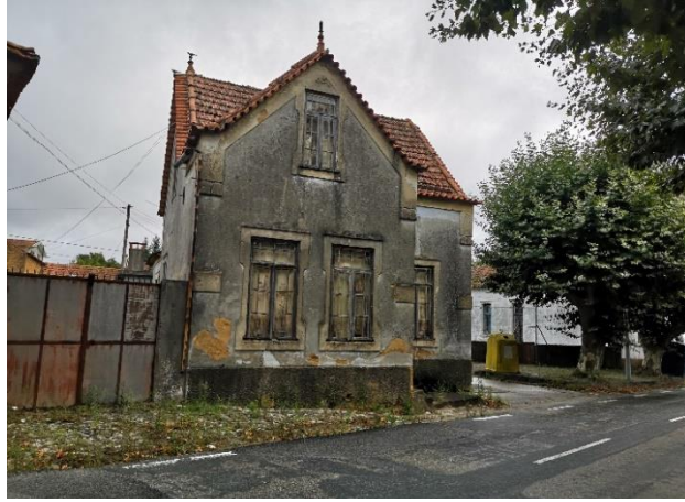
Figura 36. Manchas e bolores na fachada
