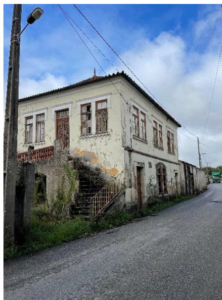
Figura 38. Desagregação do reboco
